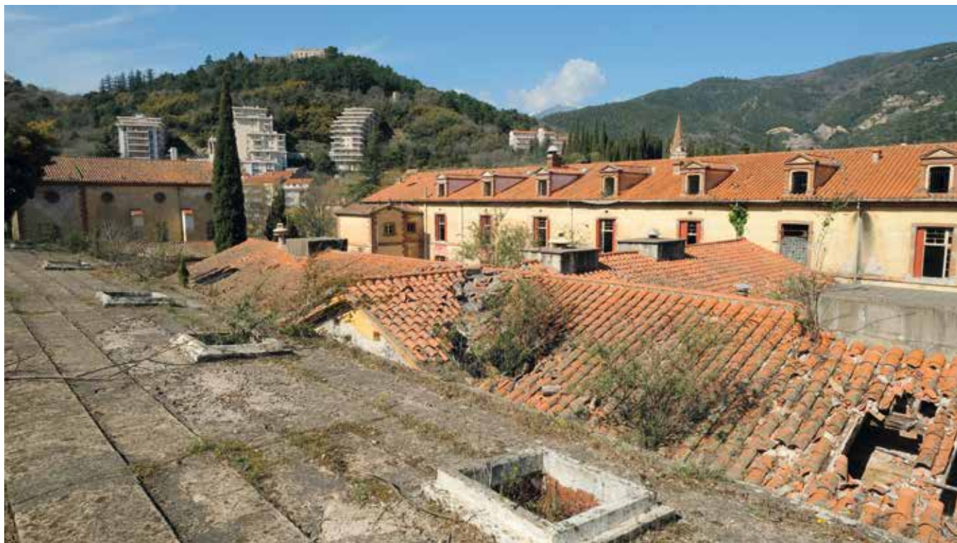
L'estat ruïnós de les teulades de l'Hospital Militar dels Banys, abandonat des de fa més de 40 anys (Hugues Argence)
